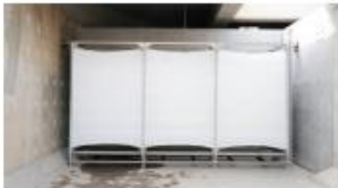
写真1.特殊繊維担体ユニット
